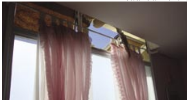
Janelas quebradas prejudicam atendimento em dias de chuva na sala de aleitamento materno
