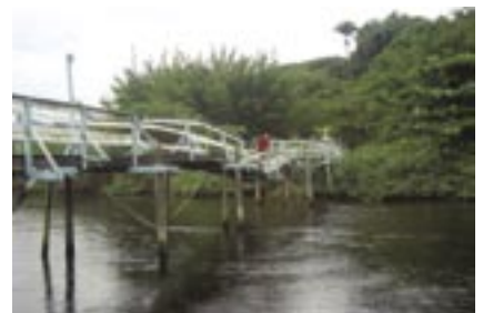
Sobre a passarela de Barra do Sahy que cedeu após diversos pedidos (não atendidos) de manutenção
